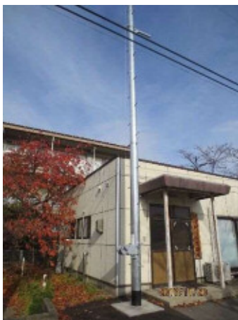
【消防ホースつり下げ柱 全景】
